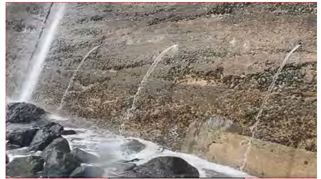
既設水抜きパイプからの出水状況
