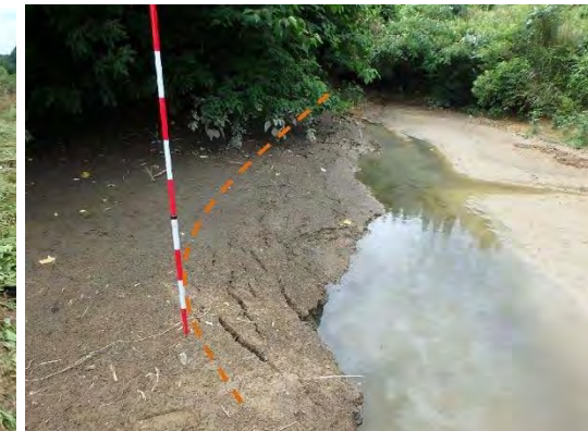
⑤ ため池内の亀裂
